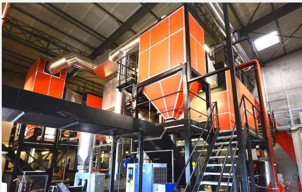
Les deux chaudières Weiss à bois de la chaufferie urbaine d'Alès ont été mises en service en 2013 (© F. Doaurd)
