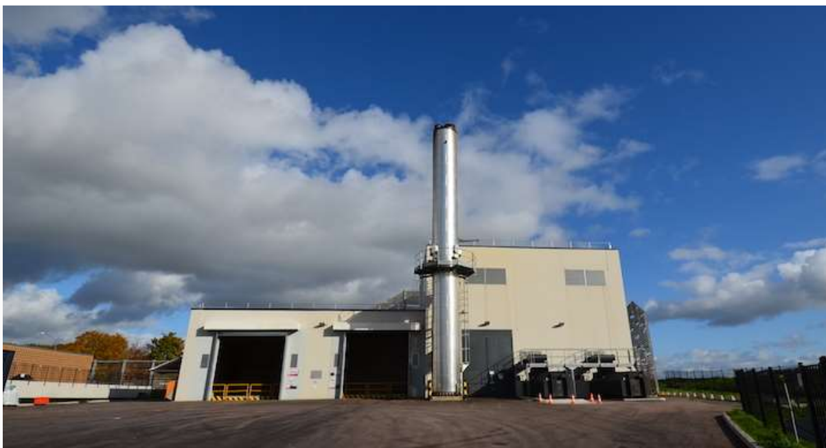
La chaufferie bois du réseau de chaleur des Mureaux
