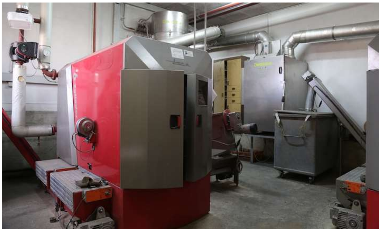
L'une des deux chaudières à plaquettes avec son filtre à particules Oekosolve Rutschmann
