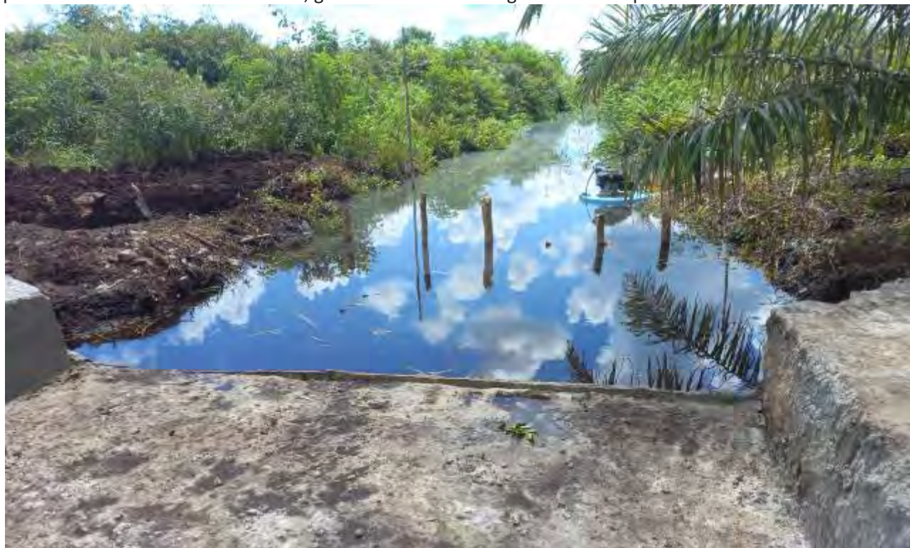
Blocage du canal dans le village de Parit Banjar, district de East Mempawah
