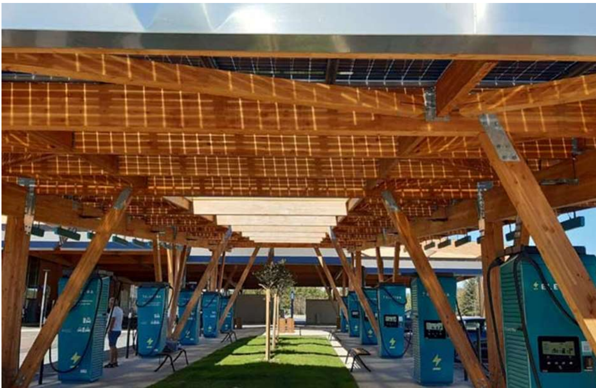
Ombrière photovoltaïque Azélan , installée sur l'aire de Garonne de l'autoroute A62 (crédit photo: Azélan )
